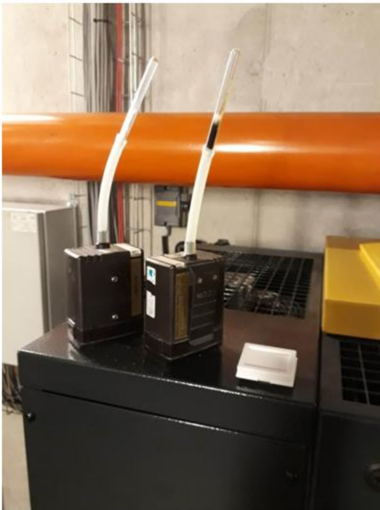
Bild 2 Stationär mätning vid rökgasrening
