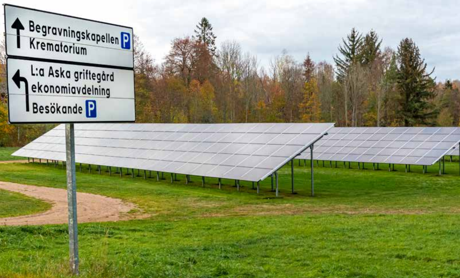
En solcellsanläggning som den vid Lilla Aska i Linköpings pastorat kan fungera som ett bra exempel på egenproduktion av el – en del av färdplanen. Kyrkogården berättade om
